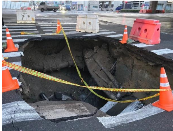
[그림 1] 애오개역 싱크홀 발생 현장
