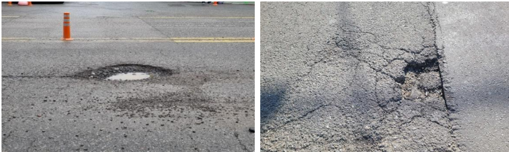
[그림 1] 도로 노면파손 사례
